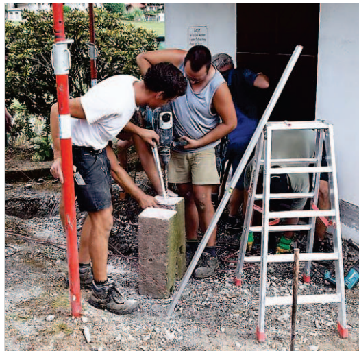
Kraft und Geschick sind notwendig, etwa beim Bohren der Sandsteinfundamente für die Stützen des Giebels.
